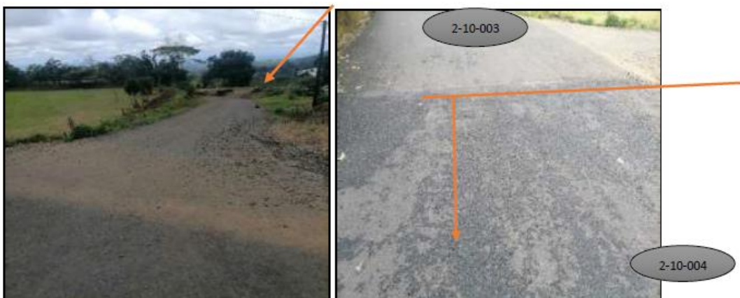
Foto N.º 35 Foto N.º 36 En la fotografía N.º 35 se muestra el final del asfaltado del camino 2-10-003 y continua en lastre. En la foto N.º 36 se muestra el inicio del asfaltado del camino 2-10-004.
