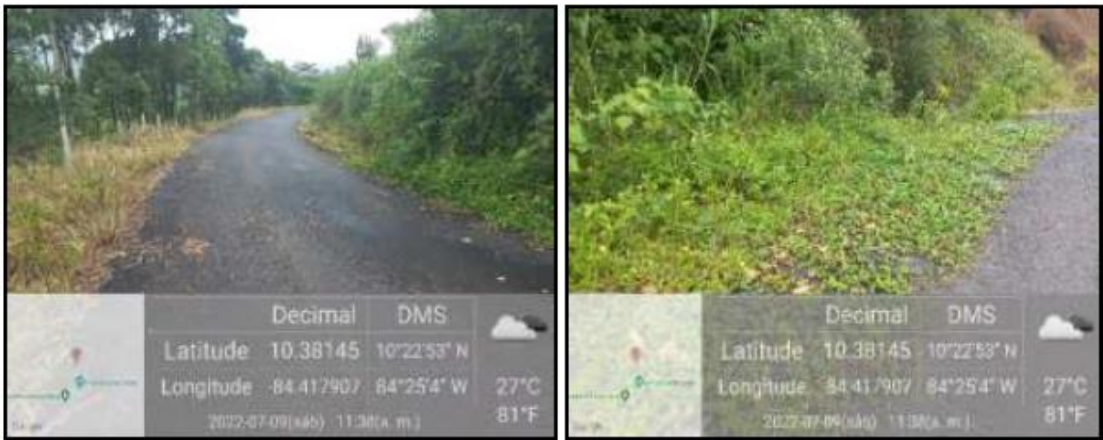
Foto N.º 62 Foto N.º 63 En ambas fotos se aprecia la falta de mantenimiento de la inversión.
