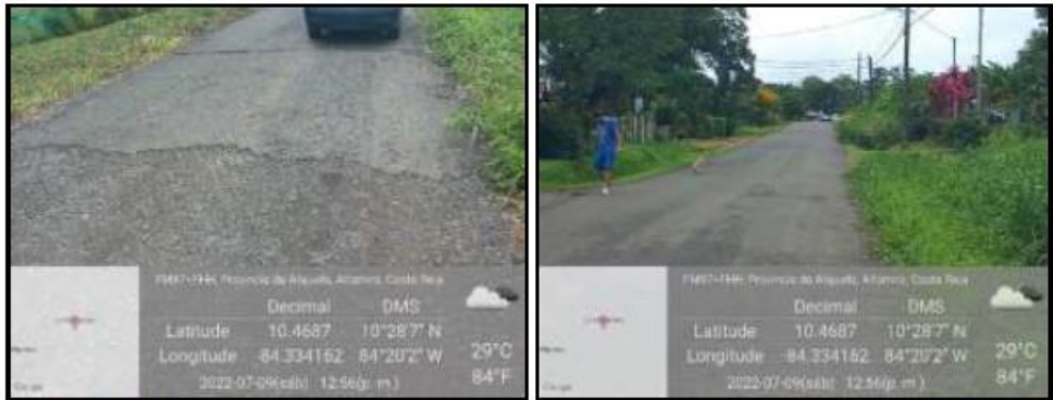
Foto N.º 78 Foto N.º 79 En la Foto N.º 78 se muestra la transición entre carpeta asfáltica y lastre, en la foto N.º 79 se observa el estado deficiente de los drenajes.
