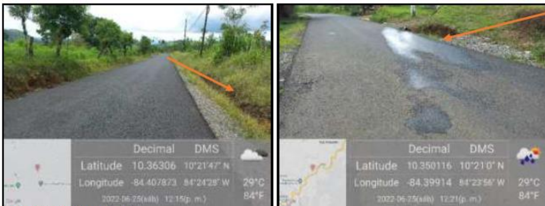
Foto N.º. 24 Foto N.º. 25: En estas fotos se muestra ausencia de un sistema de drenajes adecuados lo que podría provocar daños prematuros y pérdida de capacidad de soporte en la estructura de pavimento.
