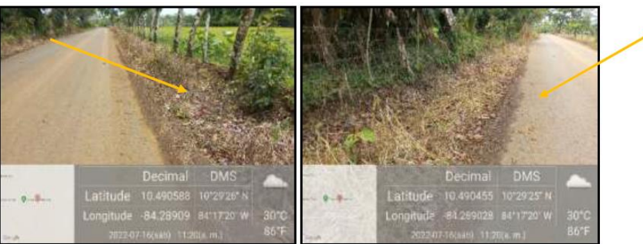
Foto N.º 104 Foto N.º 105 En ambas fotos se muestra la ausencia de conformación adecuada de cunetas en donde la escorrentía está invadiendo el pavimento.
