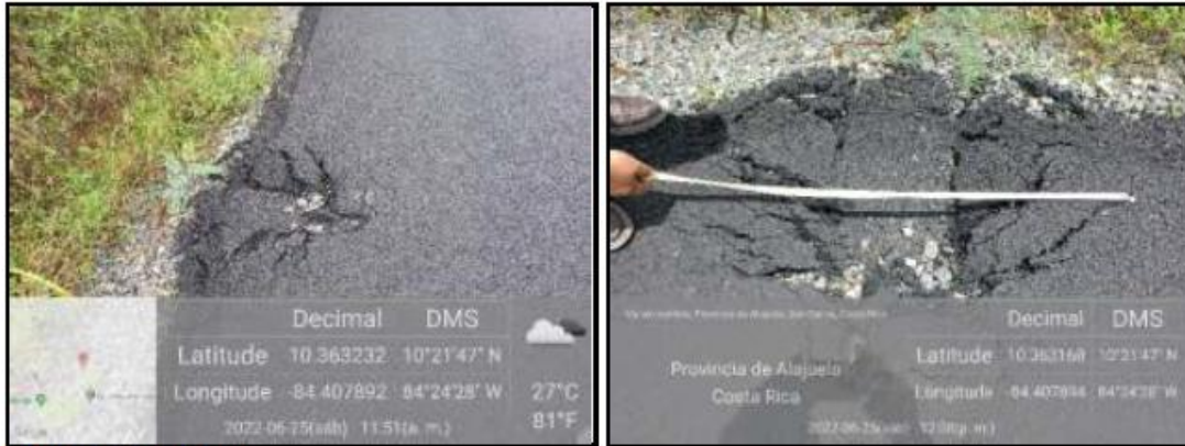
Foto N.º. 20 Foto N.º. 21 Deformaciones y daños en la carpeta asfáltica que muestran signos de posible falta de capacidad de soporte de la estructura de pavimento en conjunto.
