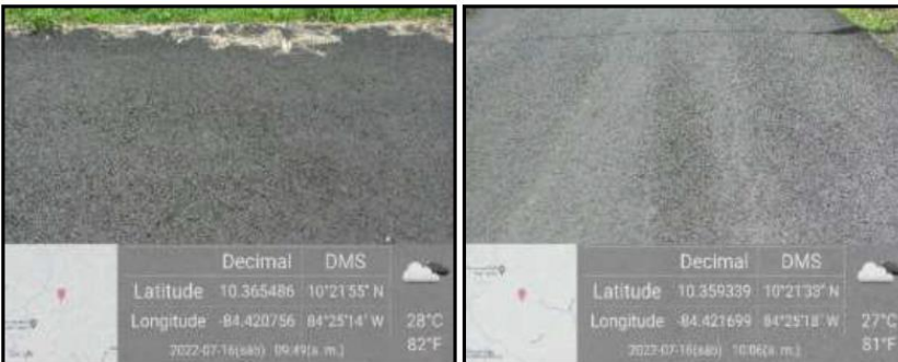
Foto N.º 100 Foto N.º 101 En diferentes tramos del camino se observó superficie con desprendimiento prematuro de los agregados, a pesar del escaso tránsito que tiene ese camino.
