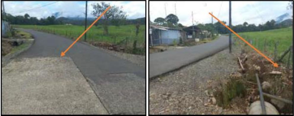
Foto N.º 74 Foto N.º 75 Inicio del asfaltado frente Escuela Calle Damas Se aprecia deficiente sistema de drenajes.
