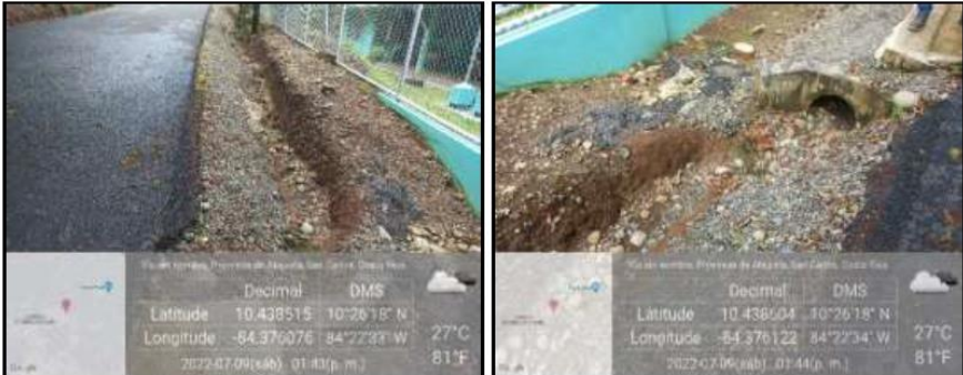
Foto N.º. 94 Foto N.º. 95 En estas fotos se muestra, frente a la escuela de ese lugar, la cuneta sin revestir con signos de erosión y la alcantarilla obstruida parcialmente con sedimentos.
