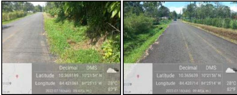
Foto N.º 98 Foto N.º 99 En estas fotos se muestra drenajes obstruidos y bordillo cubierto por suelo y vegetación.
