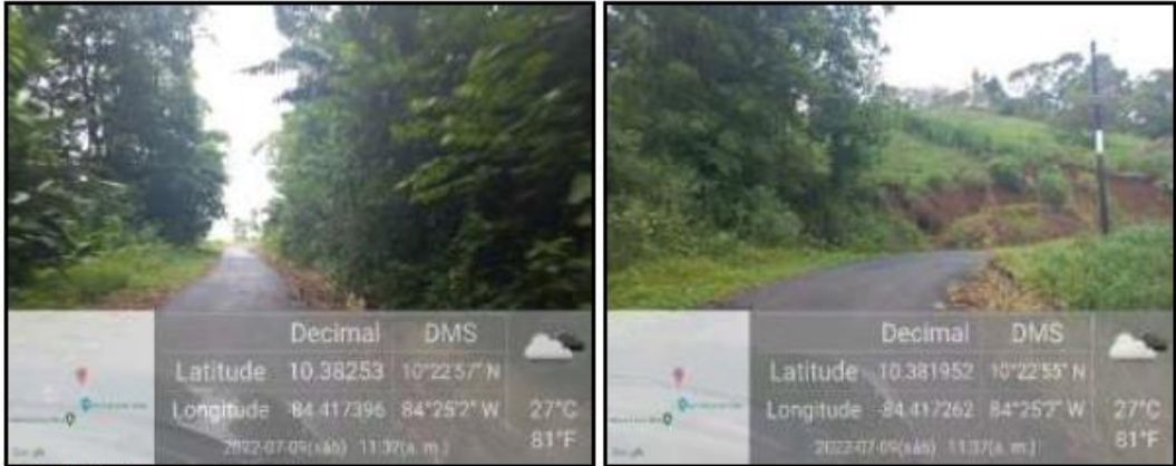
Foto N.º 60 Foto N.º 61 En estas fotos se observa la falta de mantenimiento, cunetas obstruidas y taludes colapsados.
