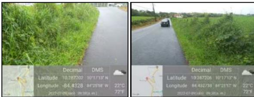
Foto N.º 31 Foto N.º 32 Se observó el día de la visita las cunetas con exceso de maleza por falta de un mantenimiento rutinario.
