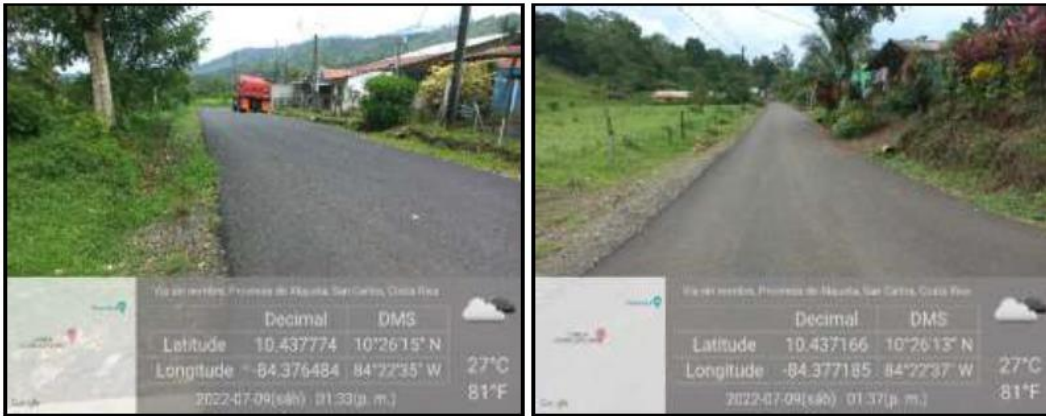
Foto N.º. 90 Foto N.º. 91 En diferentes tramos de la intervención se muestra cunetas en tierra sin conformar.
