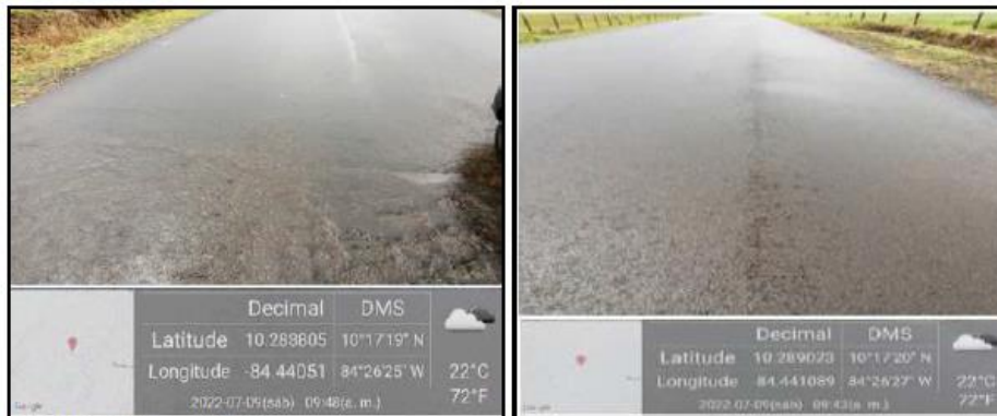
Foto N.º 33 Foto N.º 34 En ambas fotografías se muestra algunos defectos constructivos y de acabados de la carpeta asfáltica.
