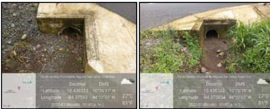
Foto N.º. 92 Foto N.º. 93 En estas fotos se muestra alcantarillas con sedimentos que reducen su capacidad de funcionamiento y evidencian su falta de limpieza y mantenimiento.
