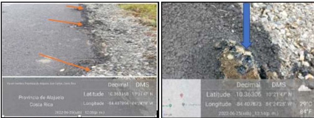
Foto N.º. 22 Foto N.º. 23: Daños prematuros sobre el borde de la carpeta que revelan ausencia de adherencia entre la carpeta asfáltica y la capa granular.
